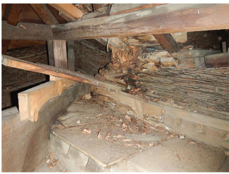
■外陣北面の軒廻り小屋裏は野地・軒付けに腐れが生じている
