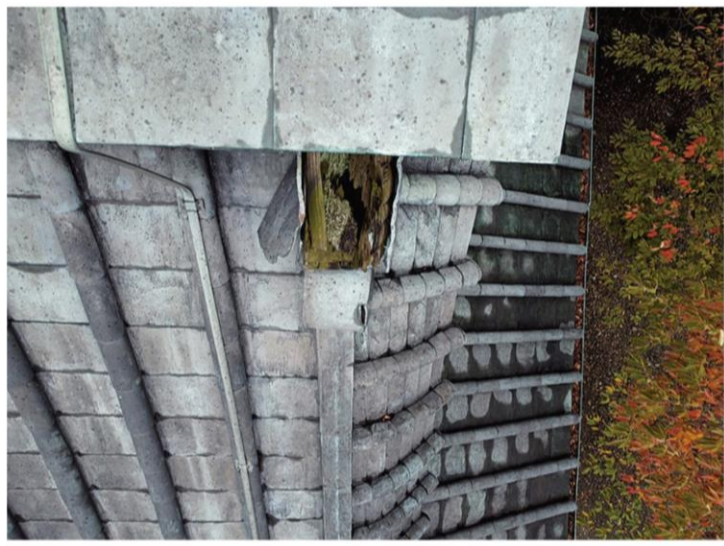
■鬼瓦の銅板包みが欠失し、木部に腐れが生じている
